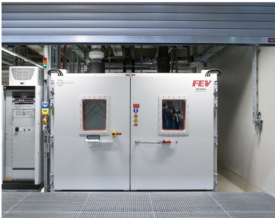
Testraum für Lithiumbatterien. | Test room for lithium batteries.
